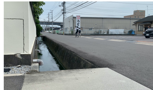
危険な用水路
